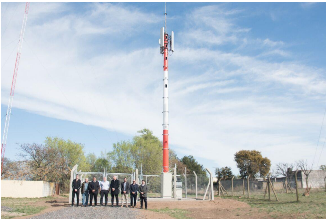
Torre 4G instalada en Tomas Anchorena
